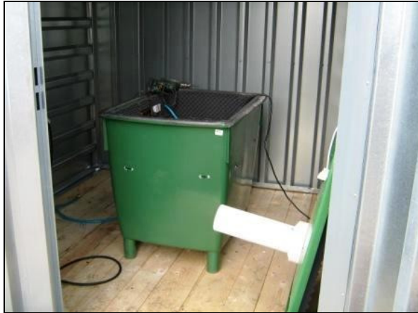
Gehäuse für den Kompressor im verschließbaren Container
