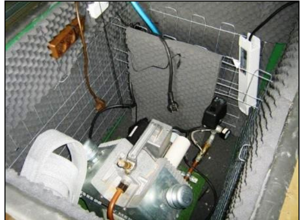
Kompressor mit Schalldämmmatten im Gehäuse
